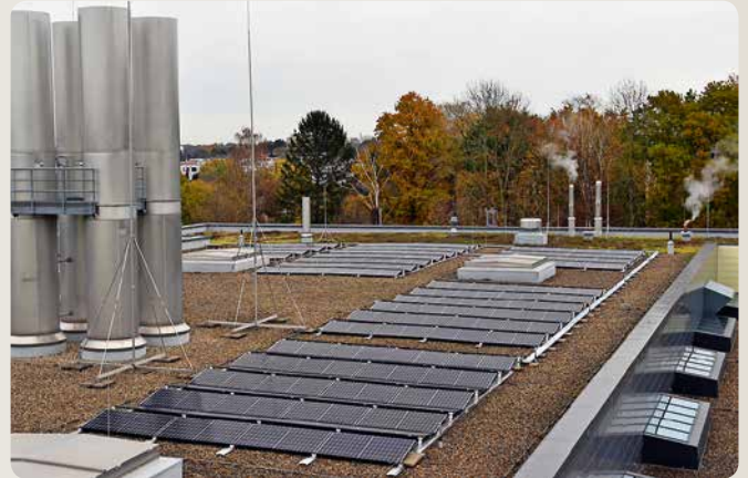
Photovoltaik-Anlage auf dem Dach des Forschungsgebäudes BeSt31.
