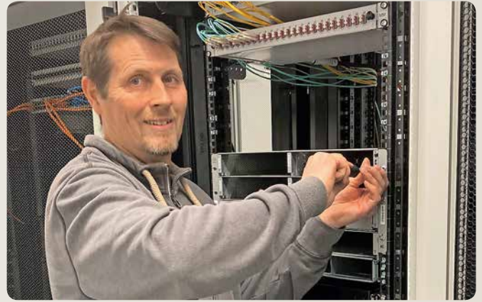
Markus Pliske aus der IDS im neuen Serverraum.
